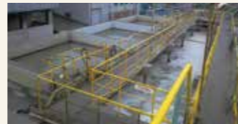
1970年 環境対策に全力で取り組み、世界の業界に先がけて、総合排水処理施設を完成。
